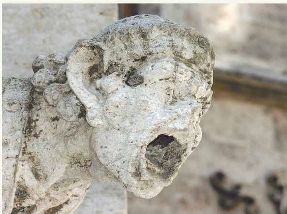
Escultura deteriorada pela ação da chuva ácida.
