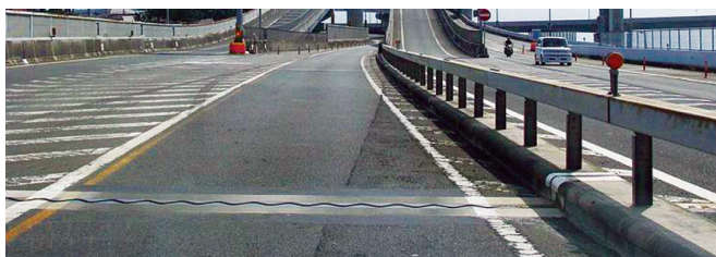
Fendas de dilatação no asfalto.
