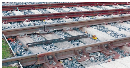
Fendas de dilatação em trilhos de trem.
